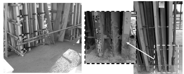
写真7 スリット脱枠・コンクリート流出状況(柱1)
