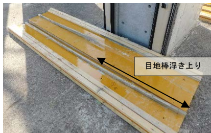
写真3 型枠変形状況
